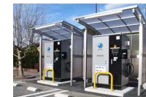
蓄電池・充電施設
