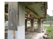
構造物の劣化状況
