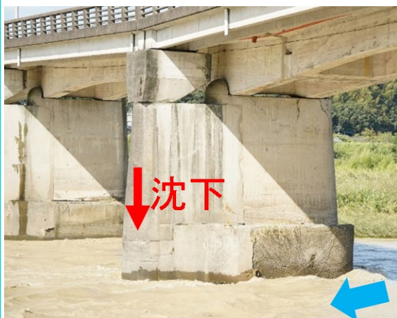
写真-1 橋脚の沈下
