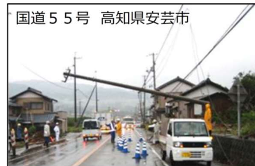
沿道民地の電柱が倒壊し道路閉塞した例
