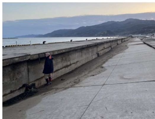
岸壁背後の被災状況
