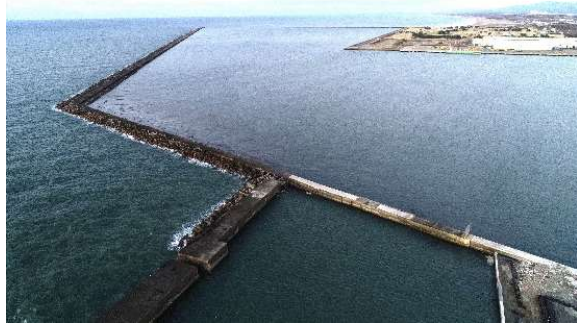
金沢港の被災状況調査(1/2)
