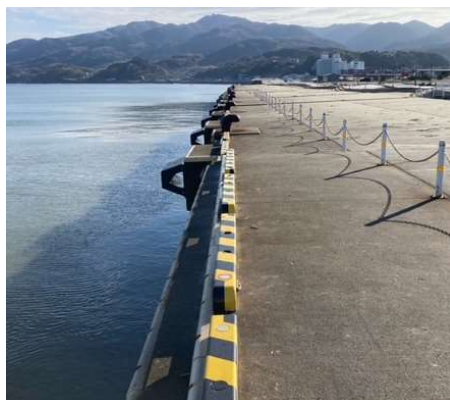
岸壁本体の被災状況
