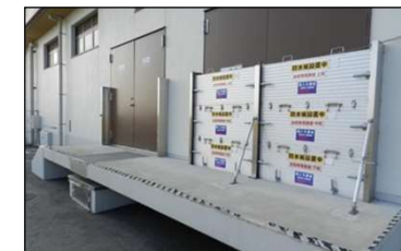
備蓄倉庫への止水板設置事例(堺泉北港)
