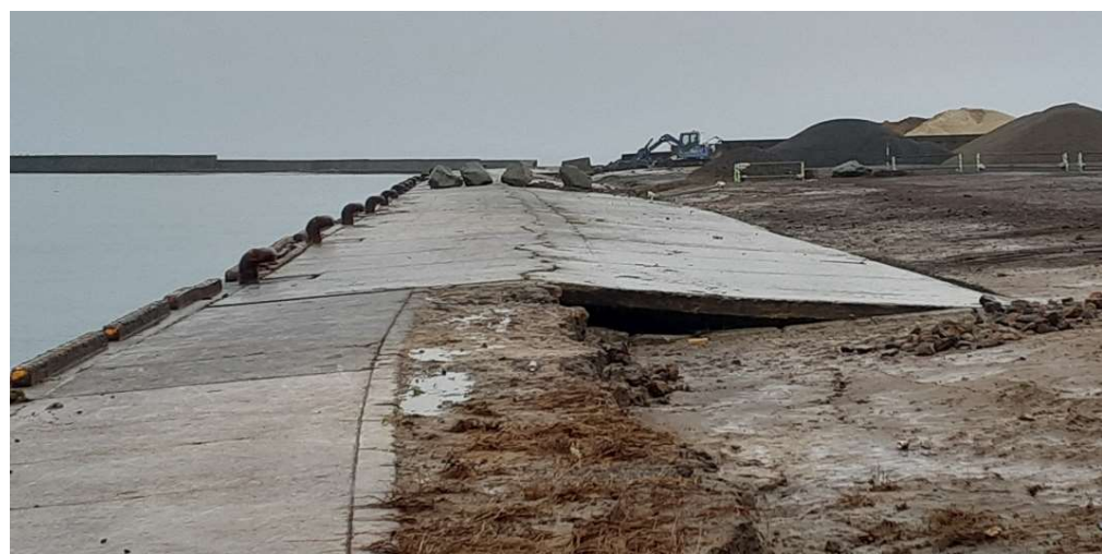
水深4.5m岸壁の被災状況
