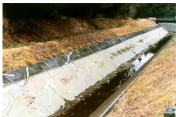
図 開水路のひび割れ
