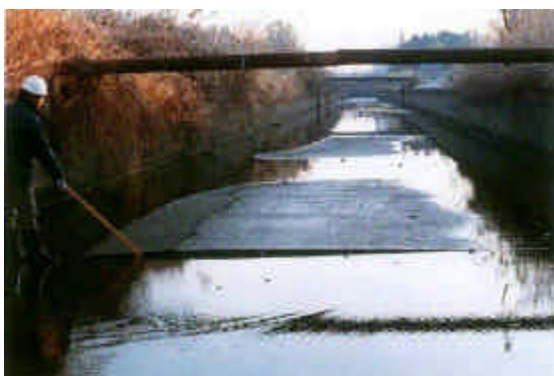
図 インバート浮上及びクラック
