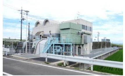
倉安川排水機場 (平成11年度整備、平成26年度ポンプ増設)
