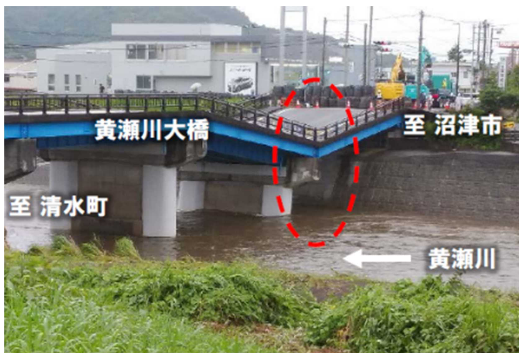
黄瀬川大橋橋脚、橋梁の損傷
