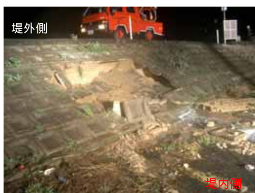
岡山県管理 海岸堤防被災状況
