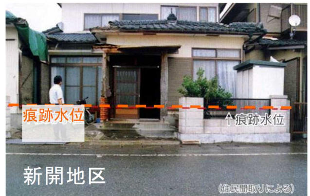
新開地区浸水状況（八代市新浜町） 《住民聞き取りによる》
