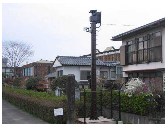
【人吉市街部の CCTV 施設】
