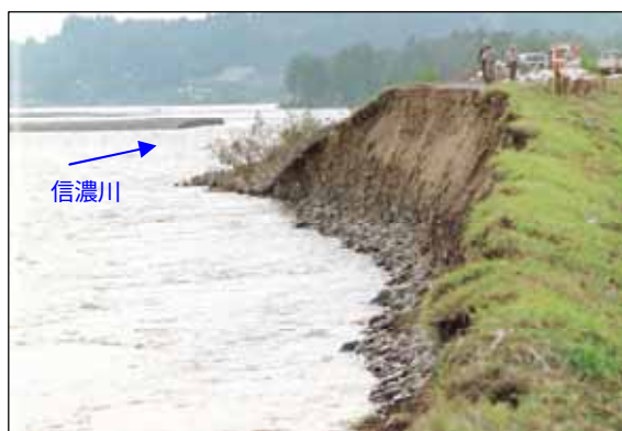
写真 4-33 十日町高島地先での堤防欠壊状況
