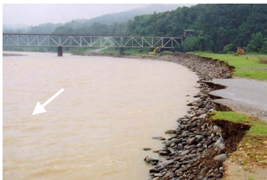
河岸侵食状況(富山市城生)
