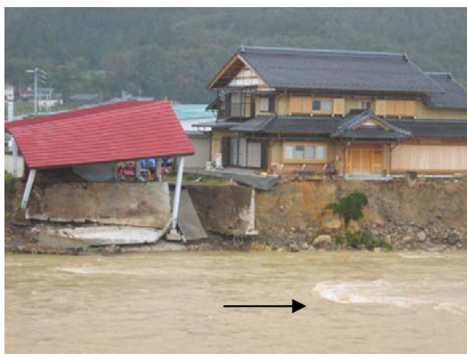
上流部被災状況 (高山市上切町)
