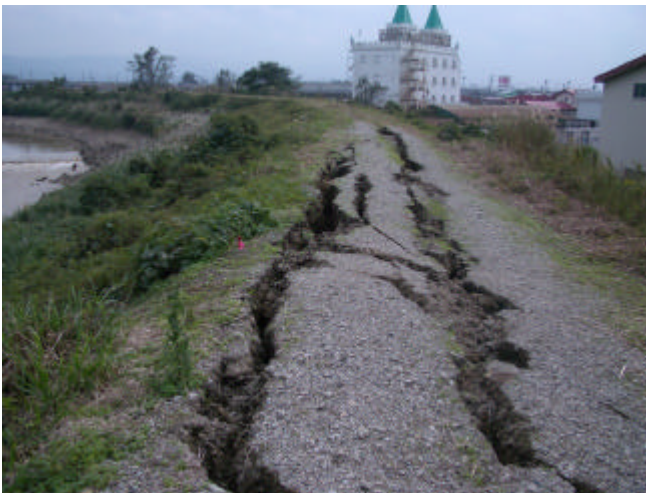
【クラックが深く刻み込まれた堤防 (新潟県中之島町(刈谷田川))】
