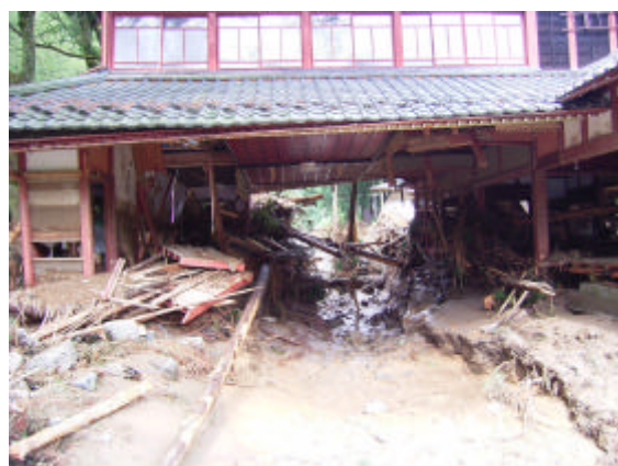
【破堤によるはん濫水により損壊した 家屋 ( 福 井 県 池 田 町 )】
