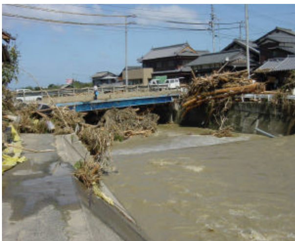
【流木が橋梁にかかり、河道を閉塞 (愛媛県小松町)】
