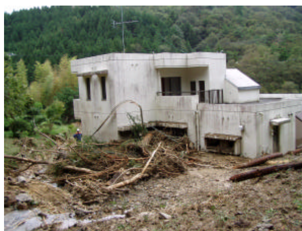
【土石流により損壊した家屋 (愛媛県四国中央市)】
