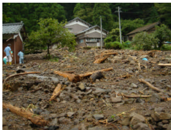
【土石流により損壊した家屋 ( 福 井 県 今 立 町 )】
