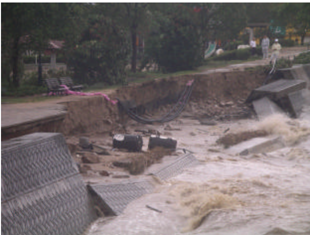
【高潮・波浪により洗掘された河岸 （広島県広島市）】
