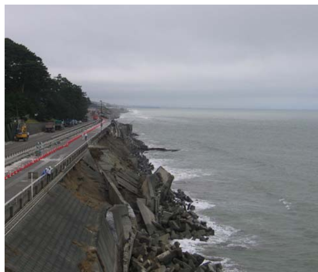
台風9号で大規模に海岸侵食が進行した西湘海岸
