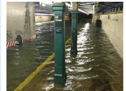
ニューヨーク市内の地下鉄駅の浸水状況 (平成24年10月)
