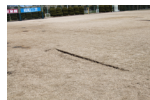
練習グラウンドが陥没 出典：鹿嶋アンソールズ、オフィシャルサイト
