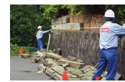
宅地部の応急危険度の判定
