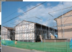
復旧資材の不足
