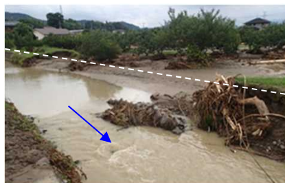
護岸の被災状況
