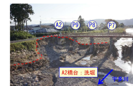
右岸被災状況
