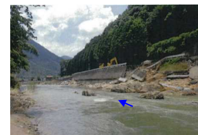
▲護岸の被災状況
