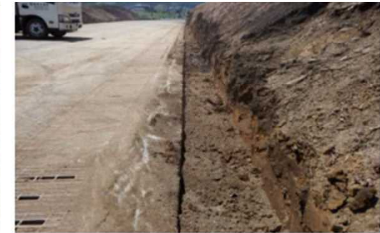
土砂撤去後の路側状況(側溝脇に基礎COが残存)
