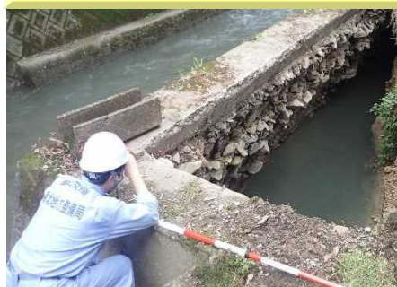
【R2.7月豪雨】 (熊本県錦町)
