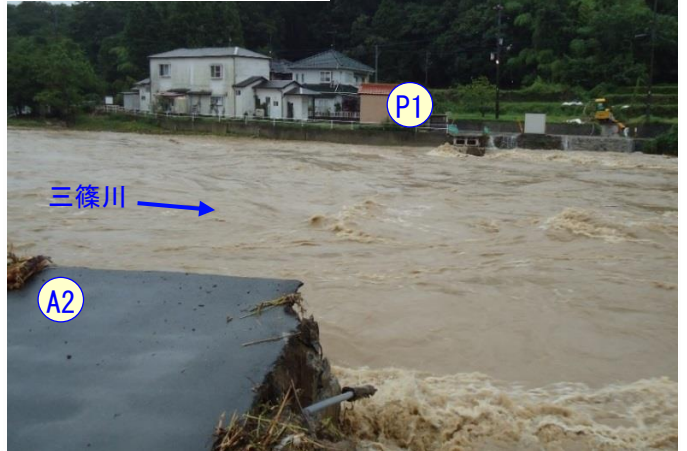
近景（5径間落橋/6径間）
