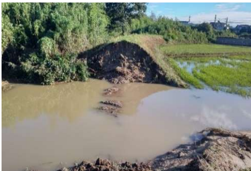
決壊した堤防
