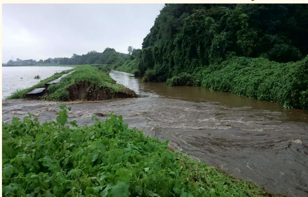
堤防決壊状況
