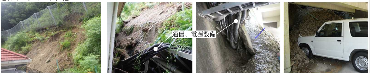
▲ダム管理所裏の法面被災状況
