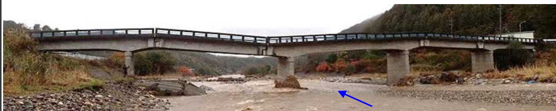
▲橋梁の被災状況
