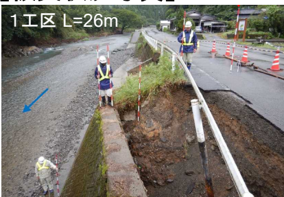
▲第1工区被災状況
