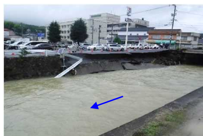
▲ ②護岸の被災状況
