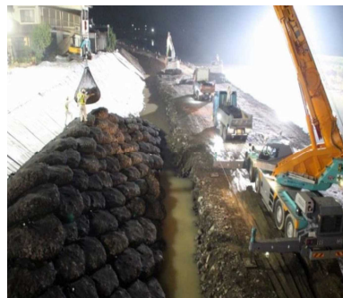
大分県建設業協会による災害対応 (平成29年九州北部豪雨)
