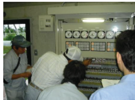
水門の開閉確認
