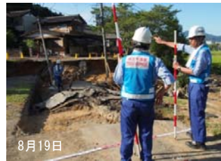
河川施設の被災状況調査
