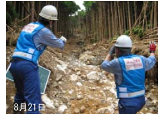
被災箇所調査(土砂災害)
