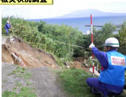
被災した町道の状況調査
