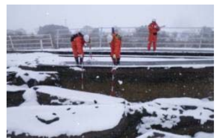
堤防被災状況の把握
