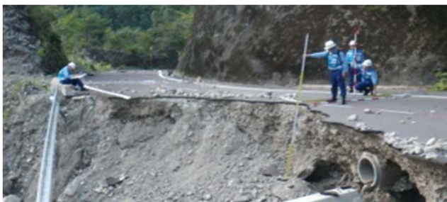
被災状況調査
