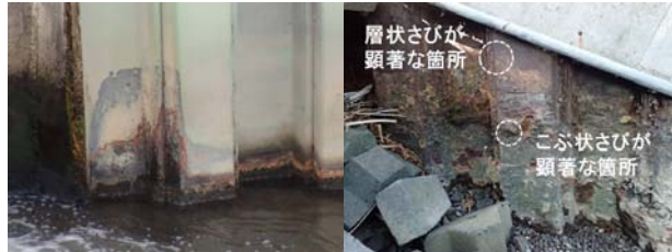
図12 落差工付近の顕著な腐食 図13 乾湿繰り返しの頻度が高い部位
