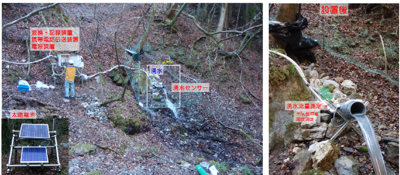
図 3-1.5 湧水センサーの設置状況
