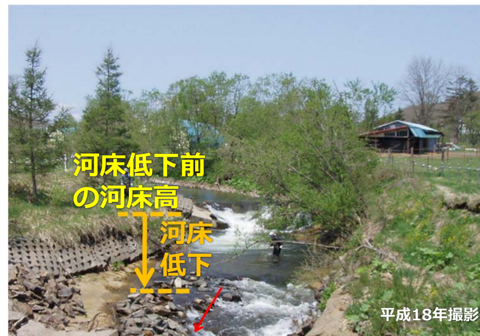
河床低下区間上流端の対策前の状況
