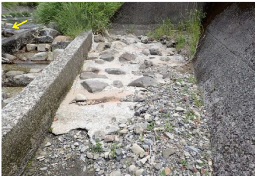
通水量不足(床止No.3)
