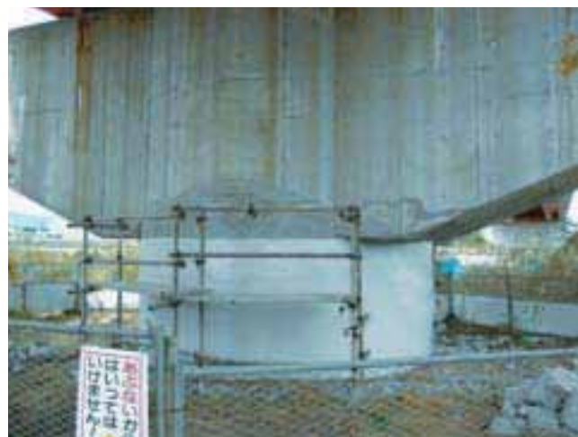
国道17号小千谷大橋の橋脚損傷現場 (小千谷市) [写真提供/北陸地方整備局]
