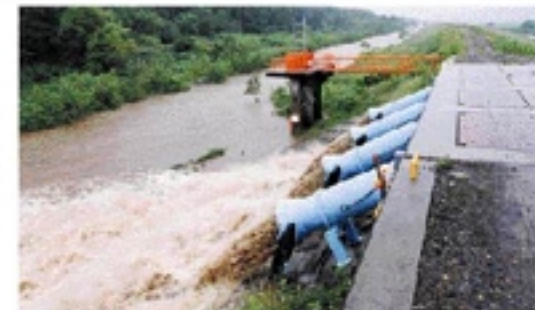
牛首別排水施設のポンプ稼働状況
