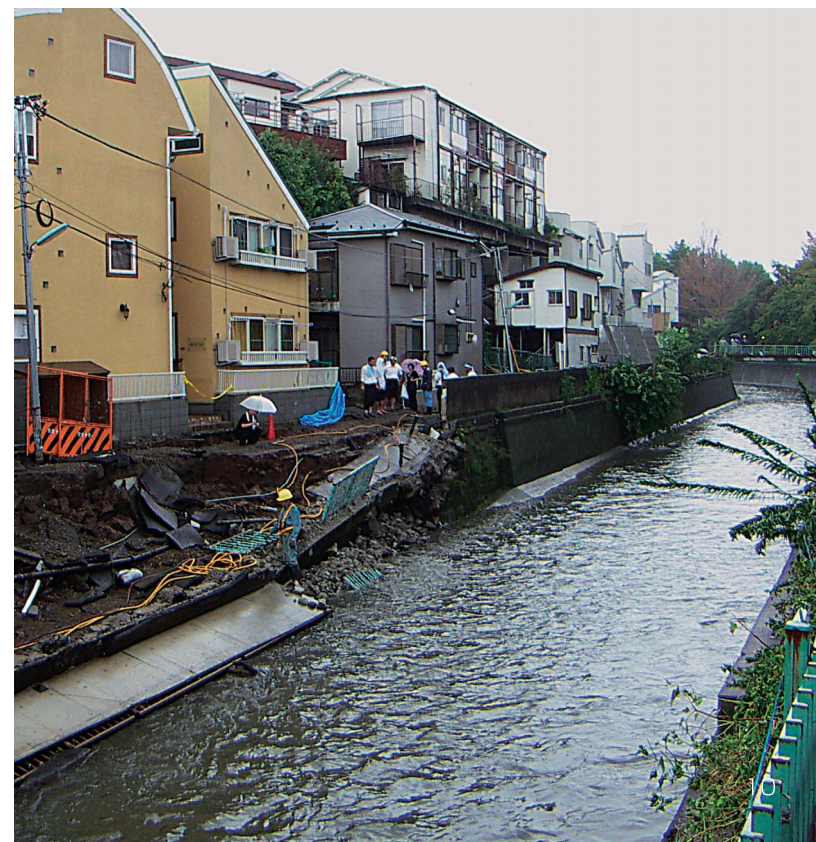
▼ 妙正寺川の被災状況（中野区）
