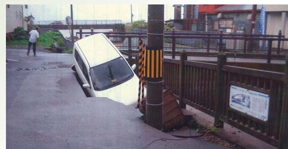
▲ 大松前川の被災状況（松前町）
