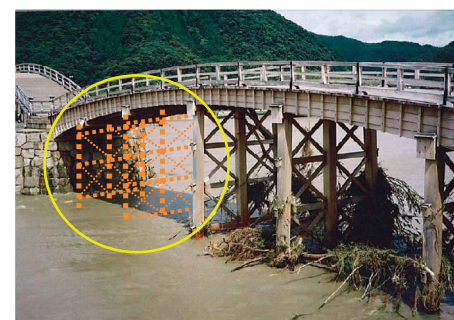
▲ 錦川の出水により橋杭が流出した錦帯橋（山口県岩国市）
