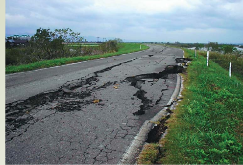
② 堤防亀裂（長岡市（旧中之島町）中条） 信濃川右岸中条地先で約1500mに渡り堤防天端に多数の縦断亀裂が発生
