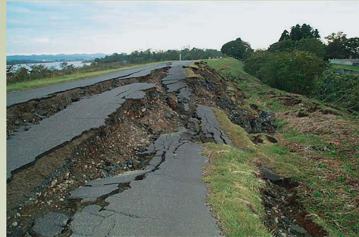
① 堤防裏法崩壊（長岡市（旧越路町）三俵野） 信濃川右岸三俵野地先で約150mに渡る裏法崩壊が発生
