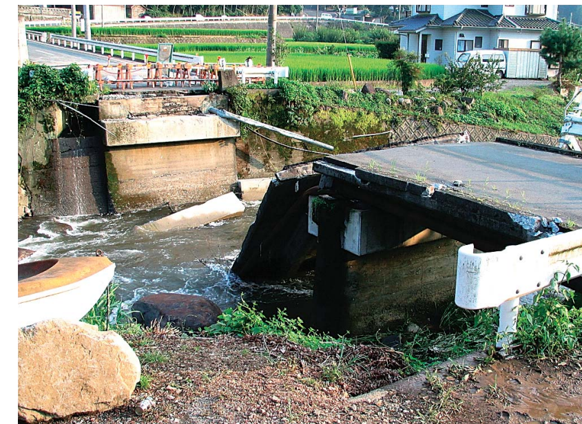
▲ 狩野川支川来光川の被災状況（静岡県伊豆の国市）
