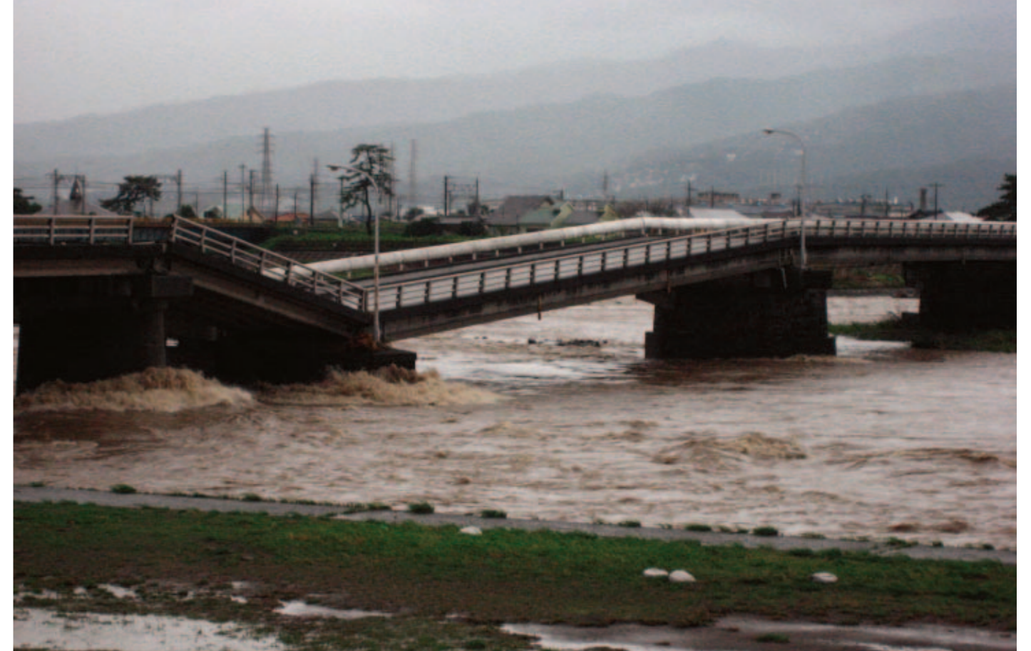
▲ 酒匂川の落橋被災状況（神奈川県松田市）
