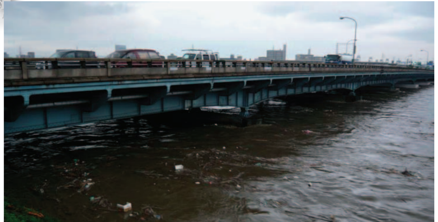
▲ 大和川の洪水状況（大阪府堺市）
