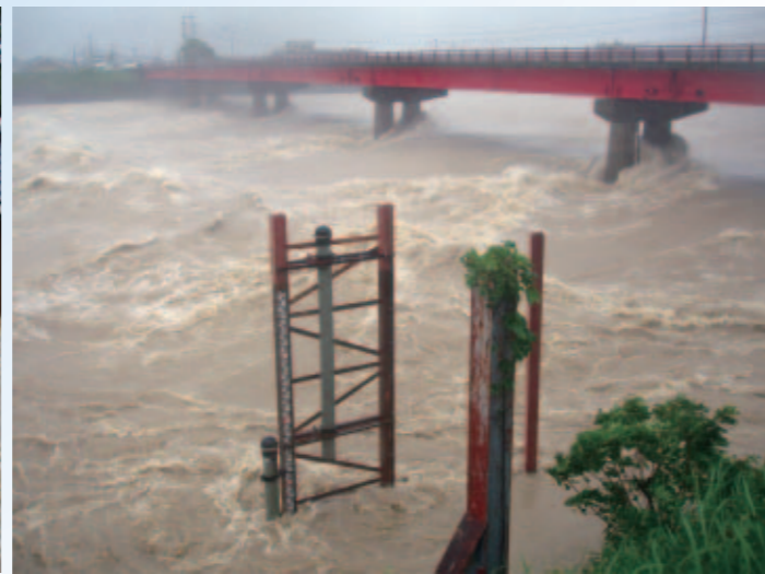
▲ 小丸川の洪水状況（宮崎県高城町）
