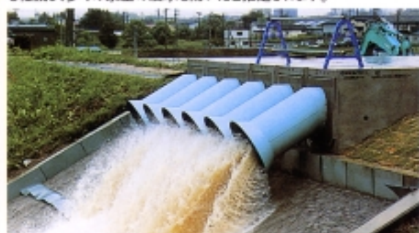
平成11年6月30日/吐出管からの排水状況
