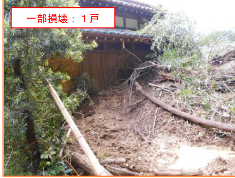
9/9 いすみぐんおおたきまちせんずい がけ崩れ 千葉県夷隅郡大多喜町泉水
