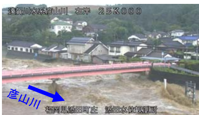
遠賀川水系彦山川 右岸 25x3000 おんががわ ひこさんがわ そえたまち 遠賀川水系彦山川（福岡県添田町） 護岸の崩落（緊急復旧完了）
