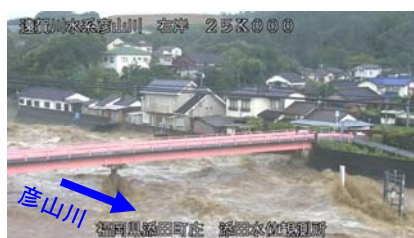
遠賀川水系彦山川 左岸 25K000 彦山川 おんががわ ひごさながわ そえたまち 遠賀川水系彦山川（福岡県添田町） 護岸の崩落（緊急復旧完了）
