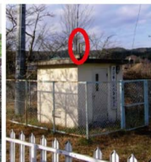
雨量計の整備
