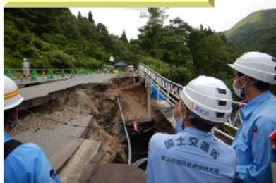
【令和4年8月の大雨】 （山形県米沢市）
