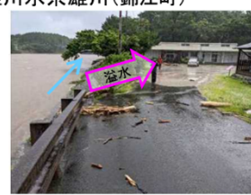
ながたがわ ② 永田川の浸水状況 (浸水解消)
