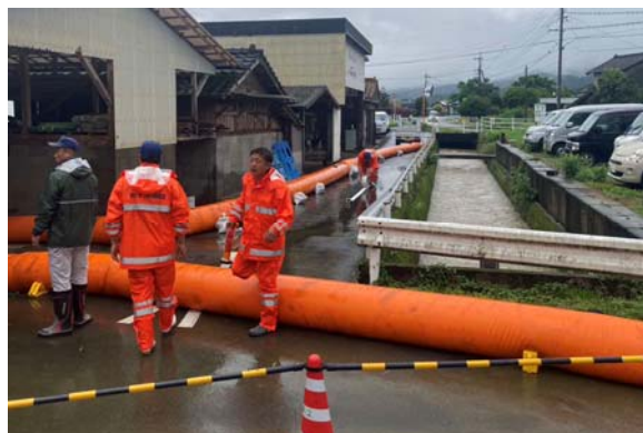
熊本県あさぎり町消防団 大型水のうを設置 ながやま (令和5年6月30日) 永山地区
