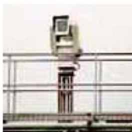
CCTVカメラの整備
