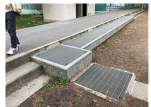
学校のグラウンドに雨水貯留する例【熊本県熊本市】
