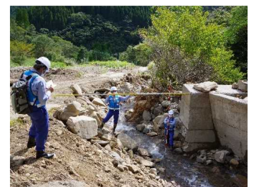
河川施設の被災状況調査 （宮崎県西米良村）
