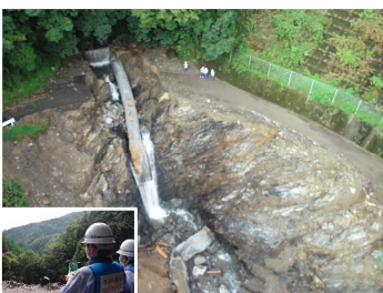
ドローンでの被災箇所確認 （宮崎県諸塚村）
