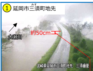
堤防天端まで約50cmの水位を記録
