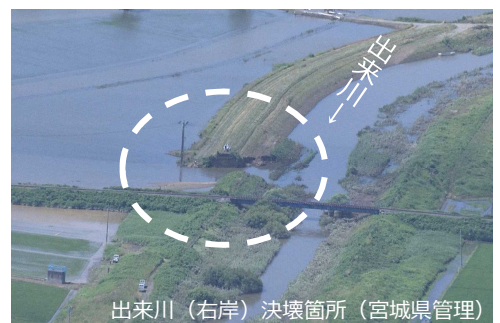
北上川水系出来川における出水・被害状況
