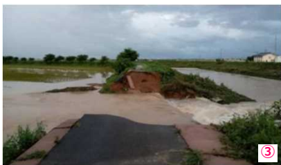
かけはし なべたに 梯川水系鍋谷川の堤防決壊（石川県 小松市）
