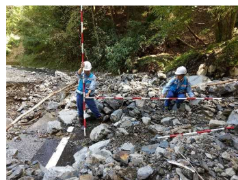
道路の被災状況調査 （宮崎県椎葉村）
