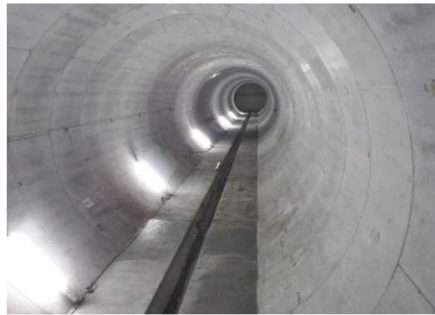
雨水貯留管(松川貯留管) 直径：5.0~5.4m 長さ：1,069m 容量：20,200m 3 平成30年供用開始
