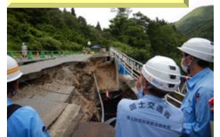
【令和4年8月の大雨】 （山形県米沢市）
