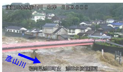
遠賀川水系彦山川 左岸 25x000 おんががわ ひこさんかわ そえだまち 遠賀川水系彦山川（福岡県添田町） 護岸の崩落（緊急復旧完了）
