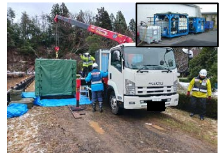
可搬式浄水装置の設置 (石川県珠洲市)
