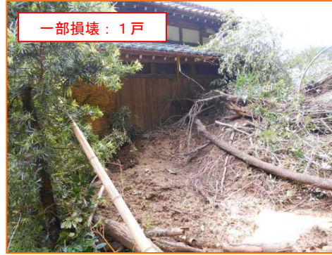
9/9 いすみぐんおおたきまちせんずい がけ崩れ 千葉県夷隅郡大多喜町泉水
