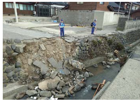
河川の被害状況調査 (石川県志賀町)
