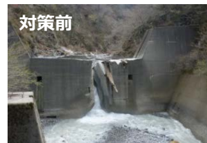
常時流水の影響による摩耗の進行
