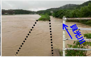
かんだがわ かずみつがわ 神田川水系員光川堤防決壊状況 しものせき (山口県下関市)
