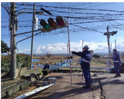
道路の被災状況調査 (石川県内灘町)
