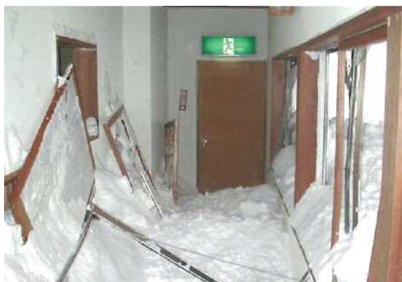
● 住宅被害状況(長野県松本市安曇)
