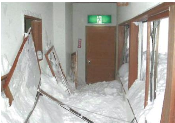
● 住宅被害状況(長野県松本市安曇)
