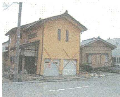
写真1-1-3 液状化による家屋被害
