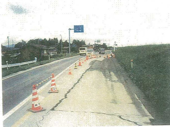
写真3-2-1 裏小段に生じた縦断亀裂および噴砂
