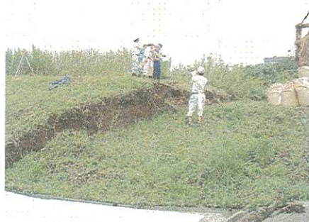
写真1-1-2 二級河川鯖石川被災状況
