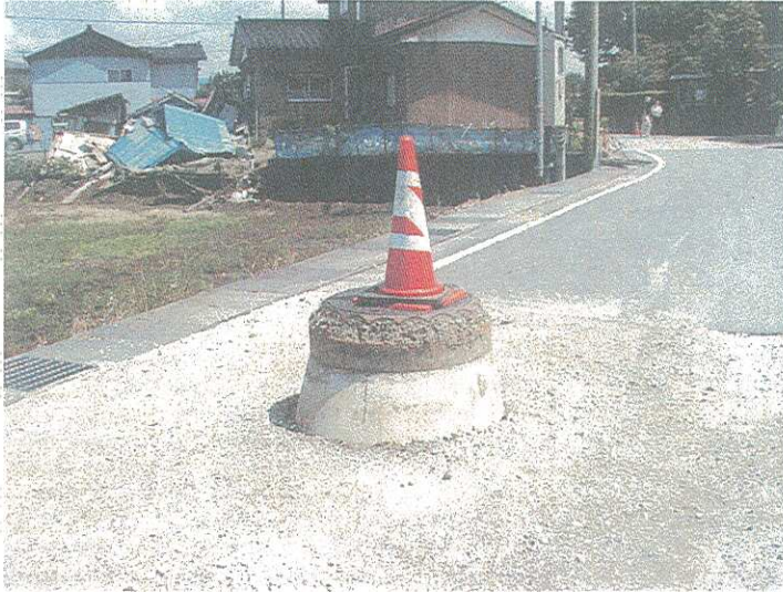
写真 2-1-3 マンホールの抜け上がり
