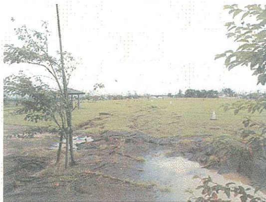
写真 2-1-1 鯖石川河川改修記念公園内の亀裂
