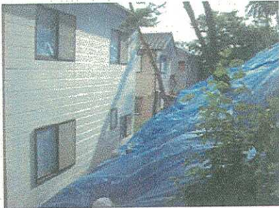
写真 3-4-5 裏山の崩壊による崖下住宅への危害
