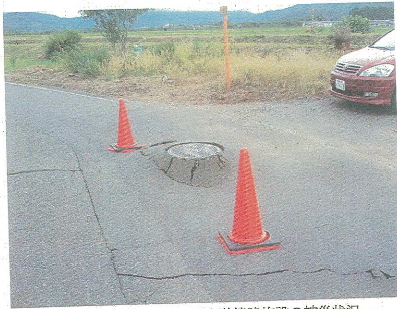
写真3-1-1 下水道管路施設の被災状況
