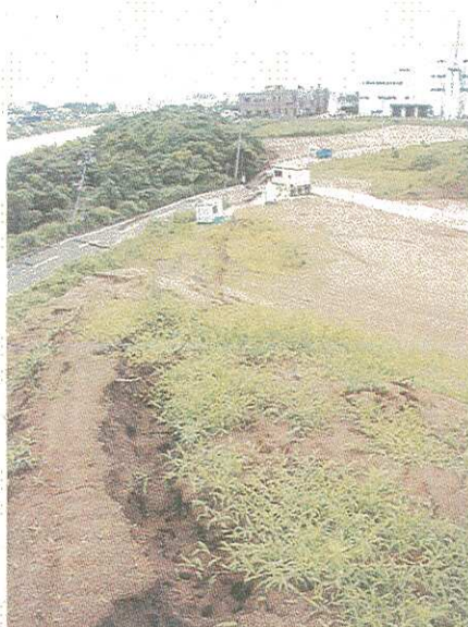
写真 2-1-2 山本集落背後の砂丘から連続する亀裂
