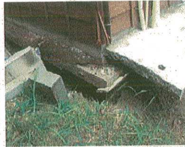
液状化に伴う住宅背面側の崖の地盤変動により下方から突き上げられた住宅
