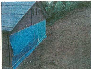
砂丘斜面崩壊による住宅の外壁等の崩壊例
