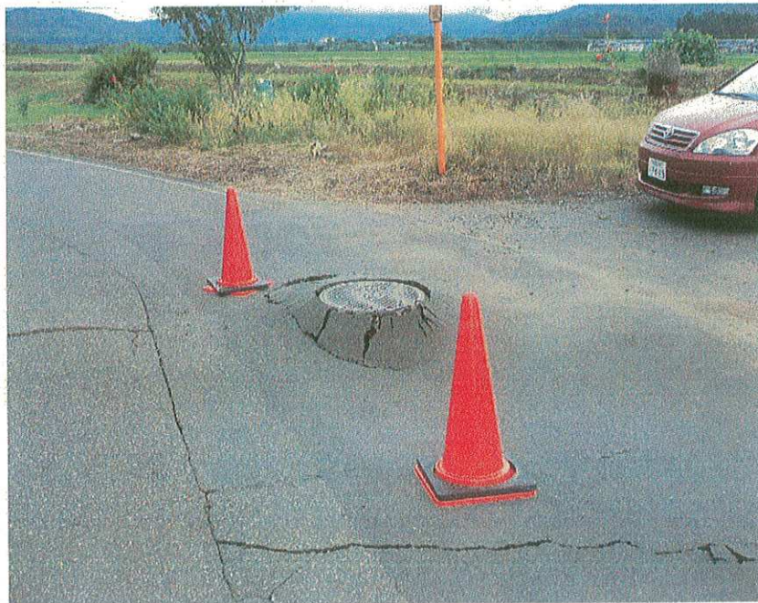
被災事例(マンホールの隆起)
